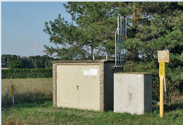
Bild 2.13: Gasdruckregelanlage Schopisdorf mit einer von zahlreichen Windkraftanlagen in der Region Fläming, Quelle: DVGW-EBI.
