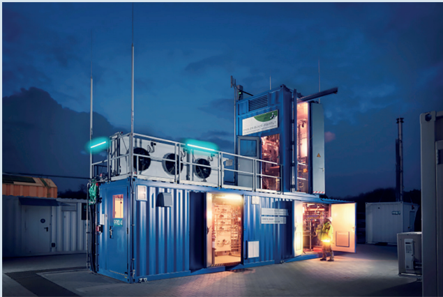
Bild 1.4: Fotografie der Dreiphasen-Methanisierung am „Energy Lab 2.0“ des KIT.
